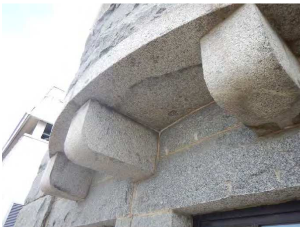
Kuva 3.24 Erkkerin alapinnassa kosteusjälkiä
