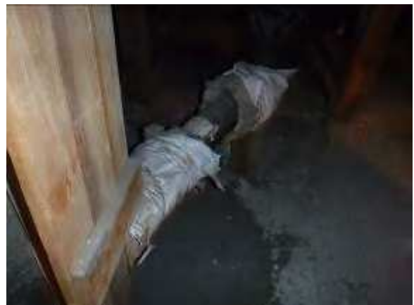
Tuuletusviemäriin eristys puuttuu lyhyeltä kohdalta ullakolla
