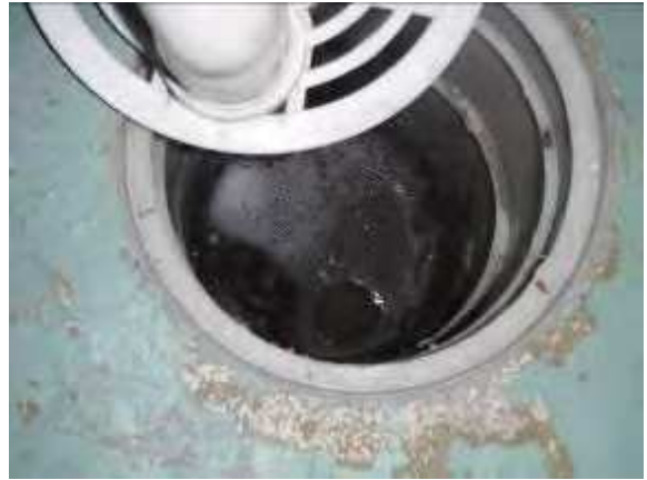
Lattiakaivot ovat pääosin valurautaisia.
