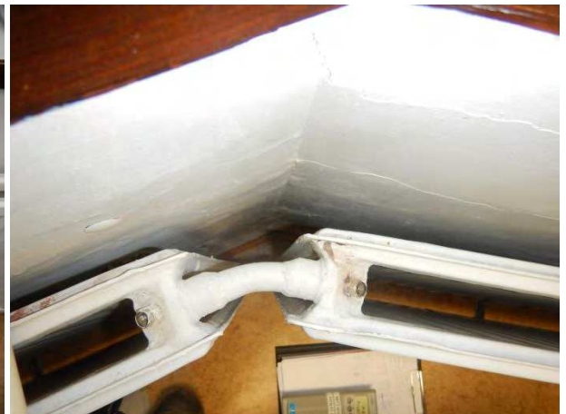
Kuva 3.23 Tilan 232 erkkerin seinän tasoite irtoilee
