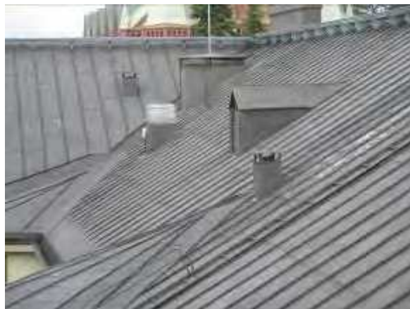
Maalin hilseilyä hieman katteessa.
