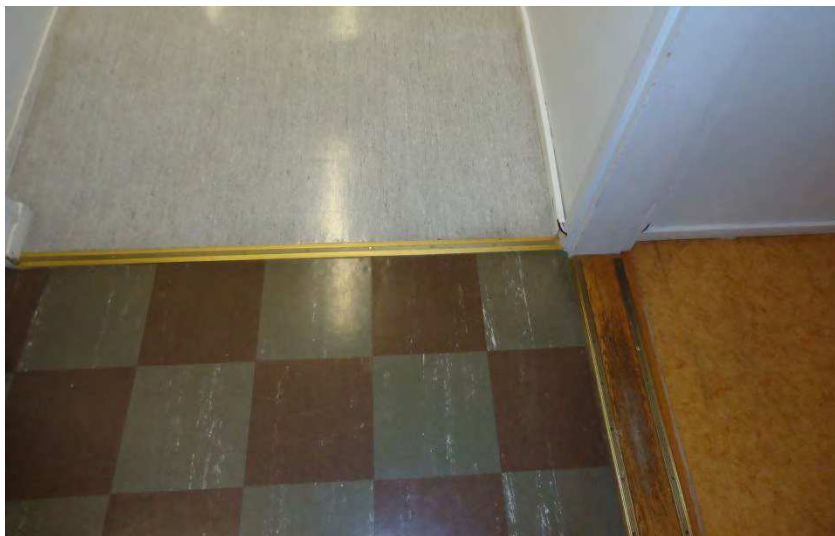
Kuva 12. Erilaisia lattianpäällysteitä. Ruutukuvion muodostava kvartsivinyylilaatoitus sisältää asbestia.
