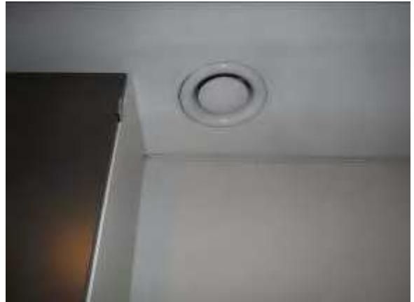
Päätelaitteet ovat koneelliseen ilmanvaihtoon tarkoitettuja malleja.
