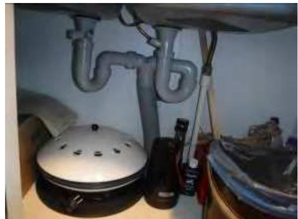
Kylmävesijohto tulee sinkityllä teräsputkella kalusteilla asti.
