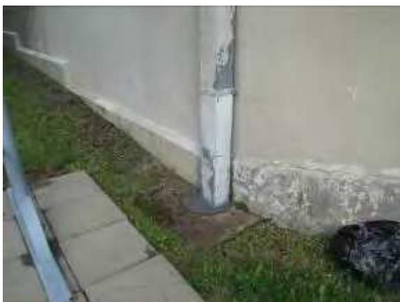
Kattojen sadevedet on ohjattu syöksytorvista rännikaivoihin. Sokkelissa on ra-pautumaa.
