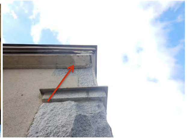
Kuva 3.17 Koilliskulmassa räystäsuloke vaurioitunut
