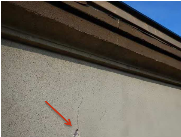
Kuva 3.12 Arviolta alustan liikkeistä aiheutunut halkeama eteläpäädyssä
