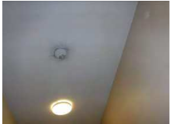
Rappukäytävissä on lautasventtiilit painovoimaisen ilmanvaihdon alueilla.
