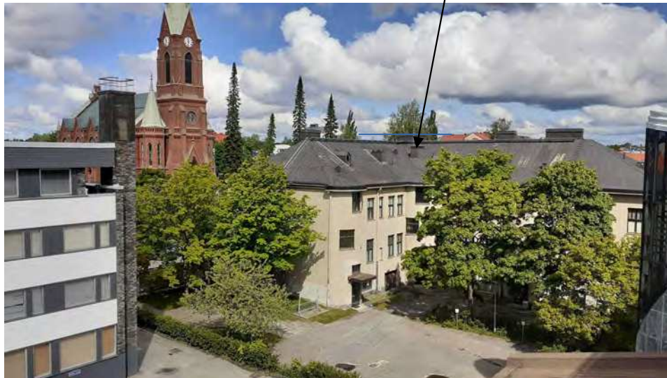
IV-laitteiden pääteyksiköitä katolla
