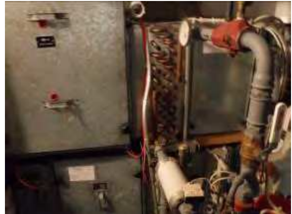
Koneisiin on lisätty lämmöntalteenottopatterit sekä lämmityspatterit ovat uusittu vuonna 1995.
