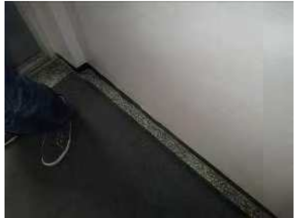
Päädyn kosteusvaurioitunutta, korjattua seinäpintaa, hieman kupruilua on.
