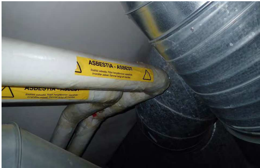
Kuva 17. Putkien eristeenä asbestia sisältävää materiaalia IV-konehuoneessa.
