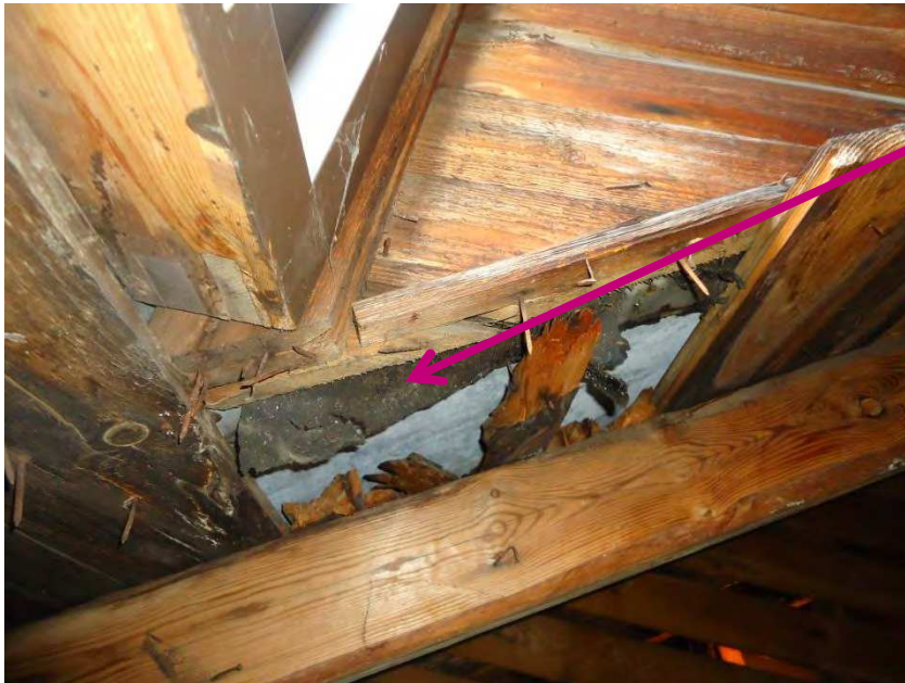
Kuva 15. Lahovaurioita kattoikkunan juuressa. Bitumihuopa sisältää sekä asbestia että PAH-yhdisteitä.
