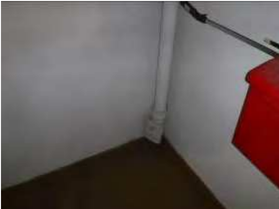
Viemärit ovat valurautaa 70-luvulta.
