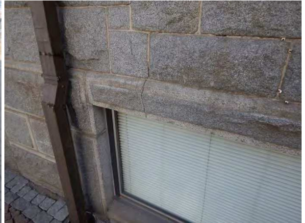
Kuva 3.31 Ikkunan yläpuolinen kivi on haljennut
