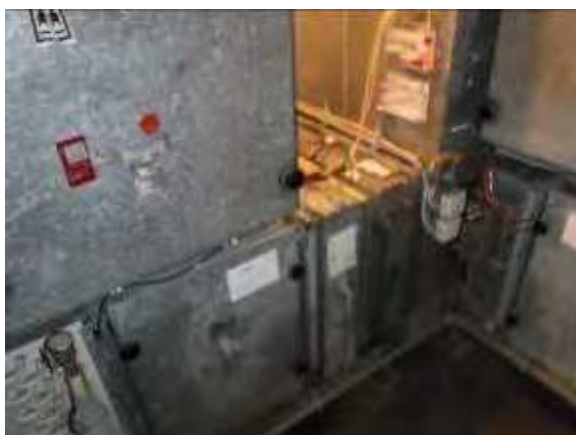
IV-koneiden säätolaitteet ovat uusittu vuonna 1995.
