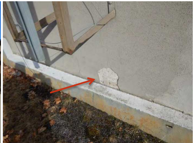
Kuva 3.13 Rappaus on irronnut alaosasta eteläpäädyssä
