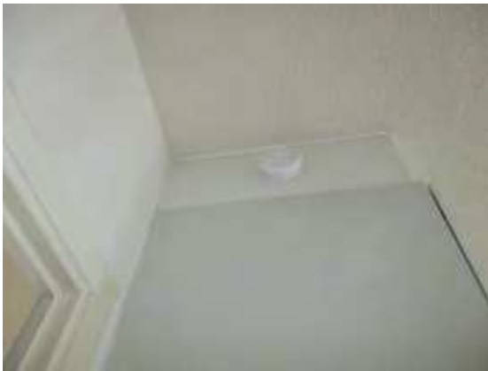
Virheellisesti asennettu palovaroitin
