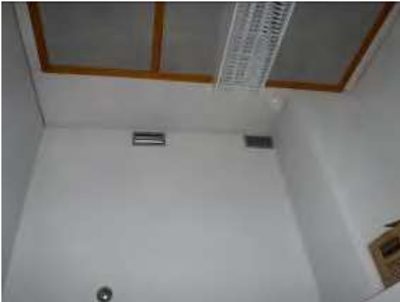
Toimistossa tulo- ja poistoilmasäleiköt
