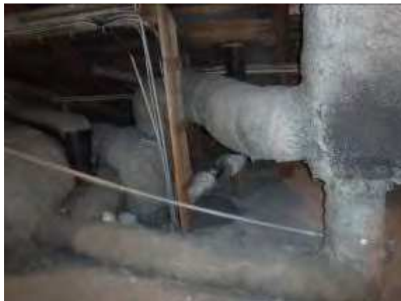
Kanavisto on eristetty ullakolla
