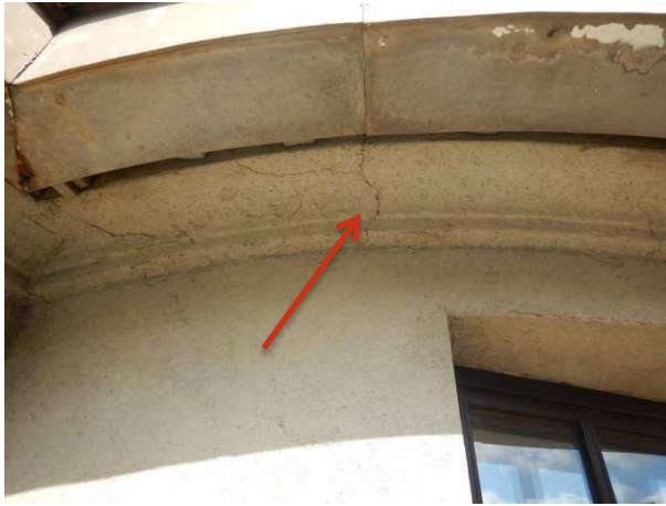
Kuva 3.16 Räystäsulokkeessa halkeamia sisäpihan nurkassa
