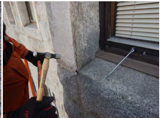
Kuva 3.29 Erkkerin ikkunan välisosan rappaus haljennut ja irti alustasta
