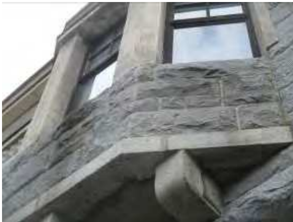
Erkkerissä on ollut kosteusongelmaa.
