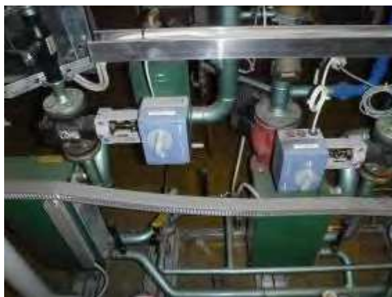
Lämpötiloja säädetään normaaleilla kaukolämmön ensiöpuolen 2-tieventtiileillä.
