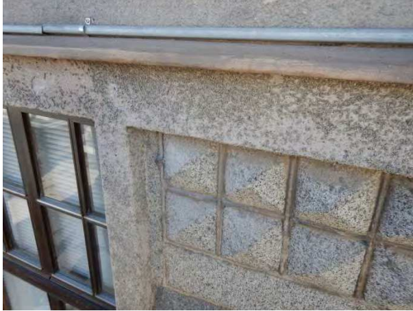
Kuva 3.26 Rappauksen pintakerros lähtenyt pois lähes kokonaan ja koristeiden saumat vaurioituneet
