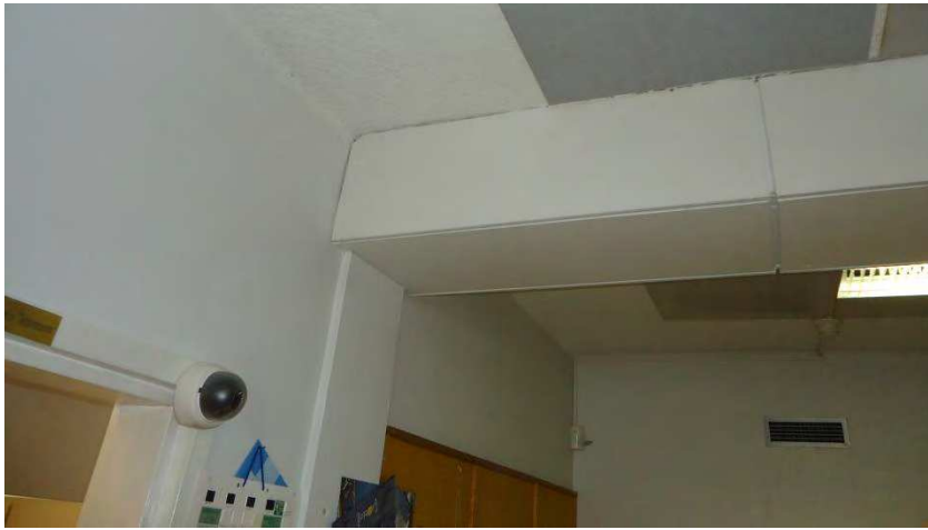
Kuva 13. Teräspalkin koteloointi pohjakerroksen katossa. Levytys sisältää hyvin todennäköisesti asbestia.
