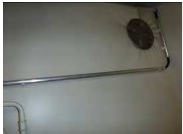
Kellarin koneellisen poiston alueilla on korvausilmaventtiilejä.
