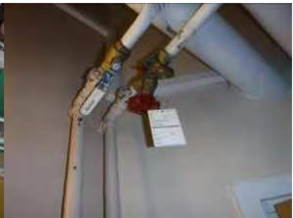
Linjaventtiilit ovat uusittu venttiilien merkintöjen mukaan vuonna 1995.
