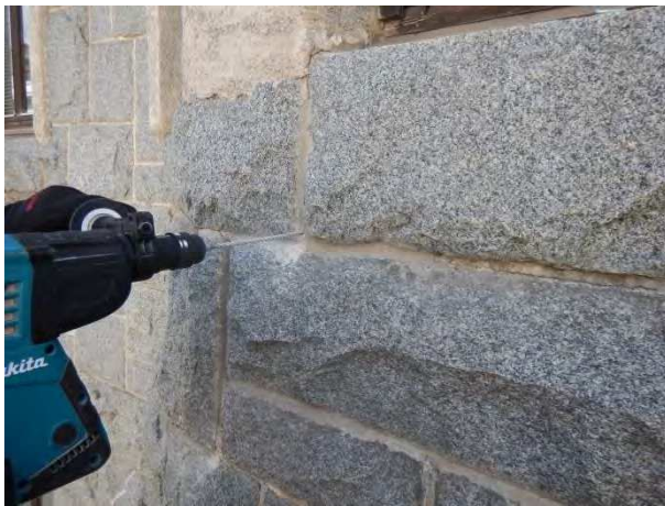
Kuva 3.32 Saumalaasti kostea ikkunan alapuolella
